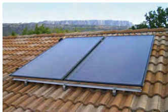
PANNEAUX SOLAIRES THERMIQUES
